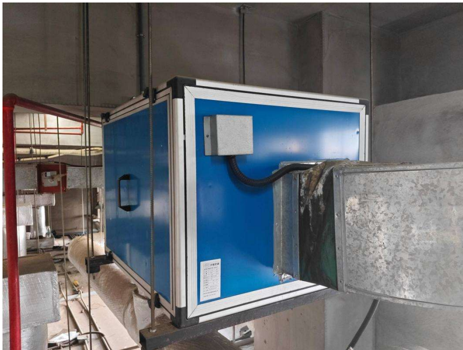
图 3-2 活性炭废气处理设施
